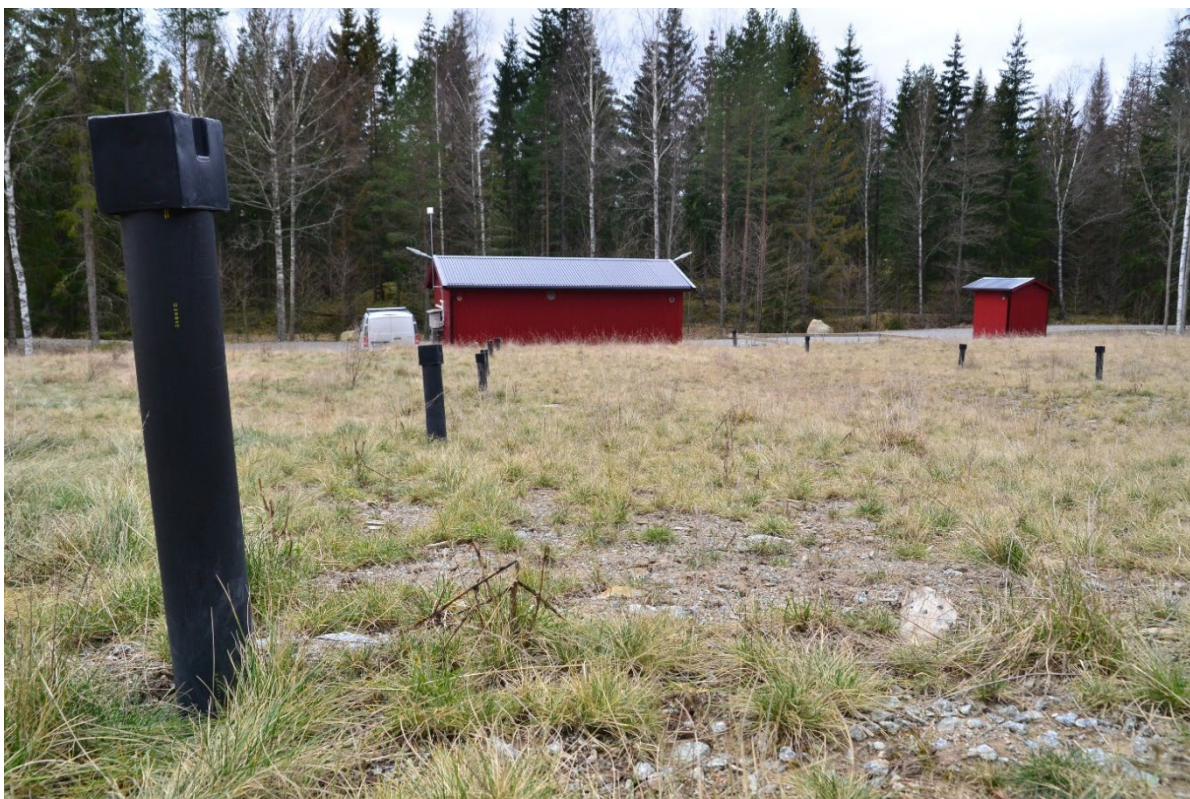
Figur 5.2. Luftningsrör i markbädd. Foto: Michael Kämpenber.
